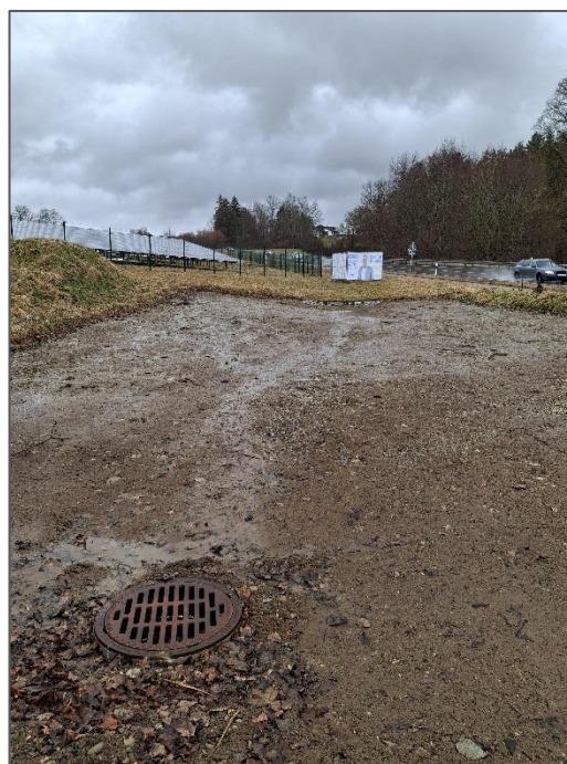
Abbildung 14: Abflussschacht im östlichen Geltungsbereich
