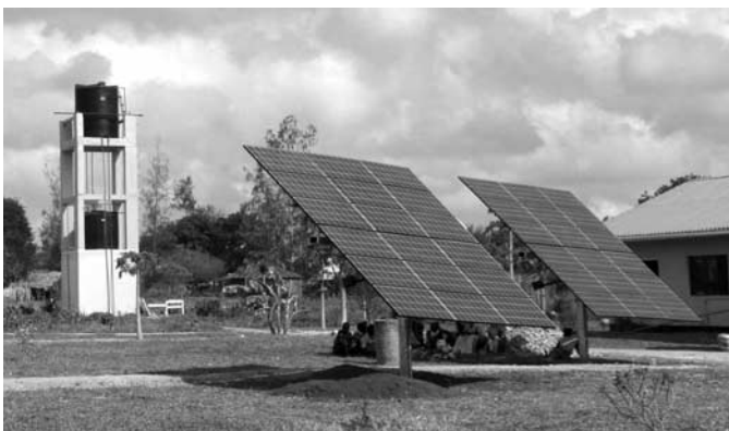
Die Solaranlage im Vordergrund betreibt die Pumpen für die Wasserversorgung mit dem kleinen Wasserbehälter für die Bevölkerung und dem großen Wasserbehälter für die Gesundheitsstation.
